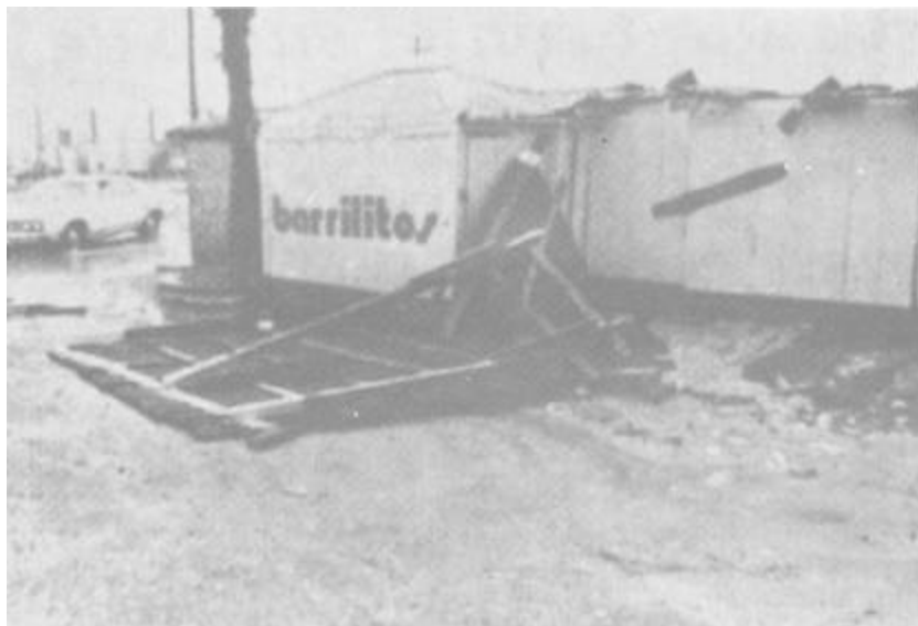
Construcciones endebles resultaron destechadas por el huracán ALLEN.
